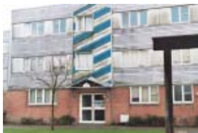
Grönalger på fasaden
