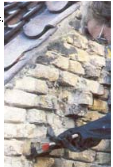
Utkratsad tegelvägg Behandlas med Boracol 20 -2Bd
